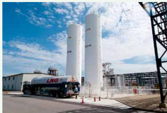
LNG供給設備
