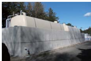
新設された排水処理施設
