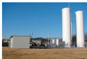
第一三共プロファーマ静岡工場のLNGサテライト
